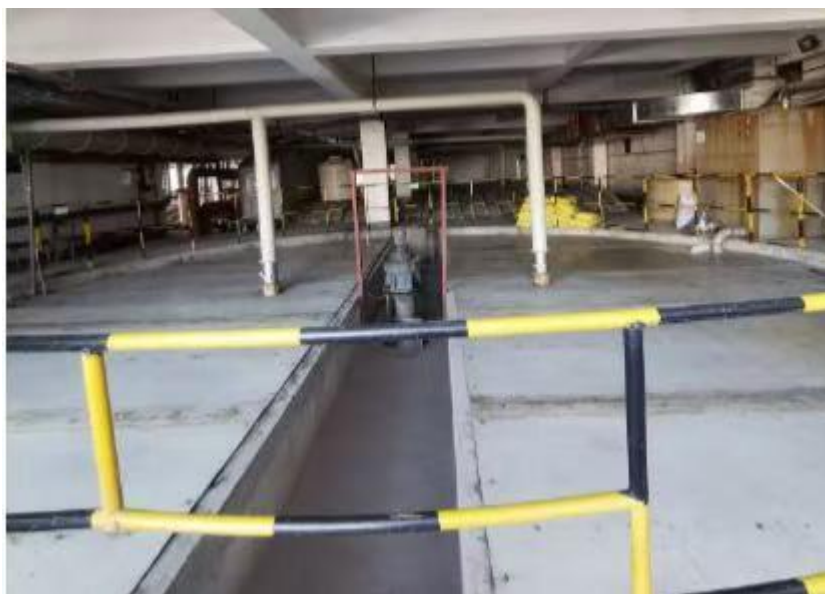
图.污水处理站
