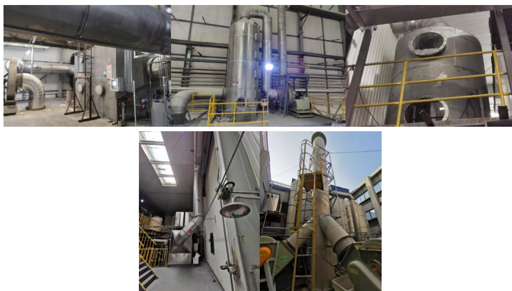
图.公司废气处理设施
